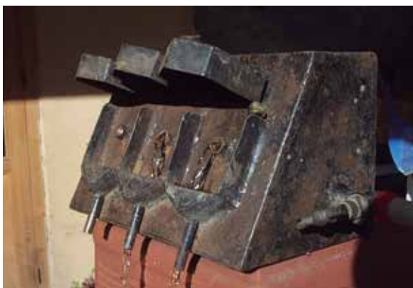
Repartidor de tres boques.
